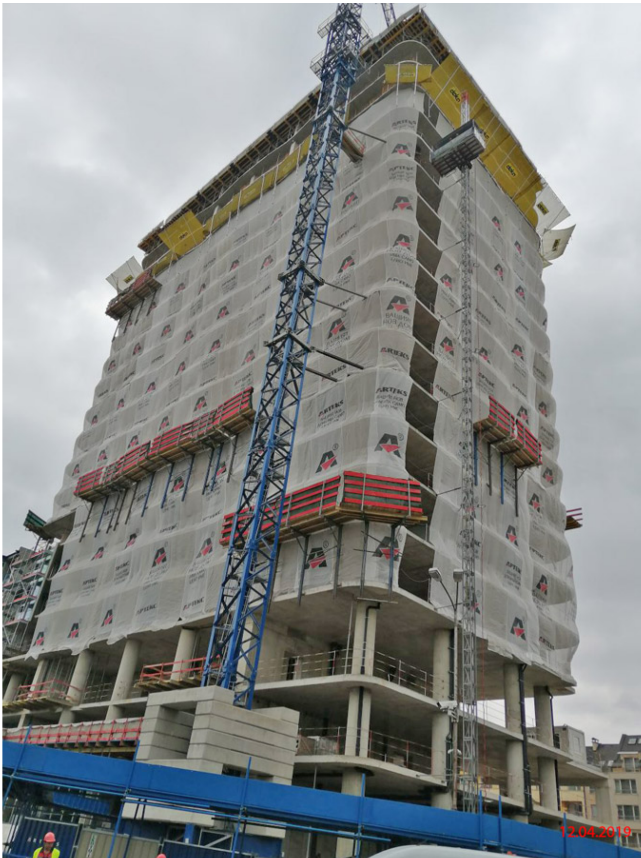
Снимка на сграда „Златен век“, спряна от ДНСК на етап 20-и етаж от строителството
